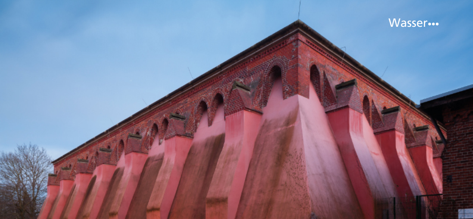
Seit fast 150 Jahren sorgt der Wasserhochbehälter für genügend Wasser in allen Hähnen. Foto: Christian A. Schröder / Wikimedia (CC BY-SA 4.0)
